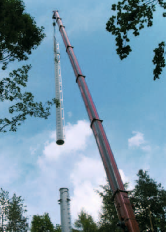
Montage eines 40 m Schleuderbetonmastes in Königshausen i.Bay., Stadtteil Hofstetten (Landkreis Haßberge) Foto: Bayerische Staatsbauverwaltung
